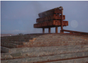
أحواض تبريد المياه الحارة بجبيل
